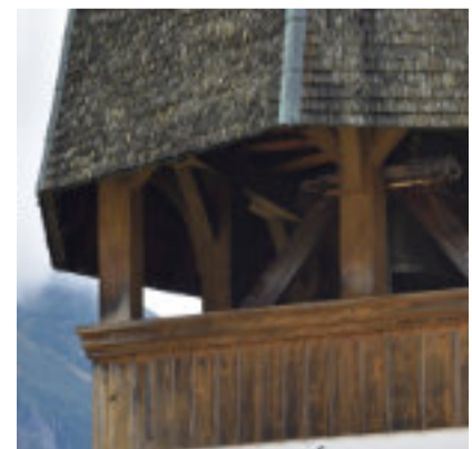
Die Schindeln sind stark verwittert und werden ersetzt.
